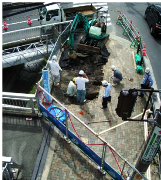
石屋川右岸の漏水事故 （平成 25 年 8 月）
