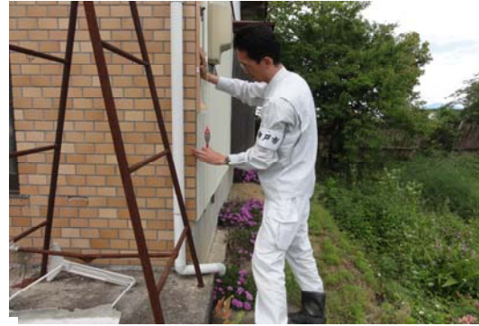
写真2 名取市でのり災害調査 ('下げ振り'で建物傾斜を計測)
