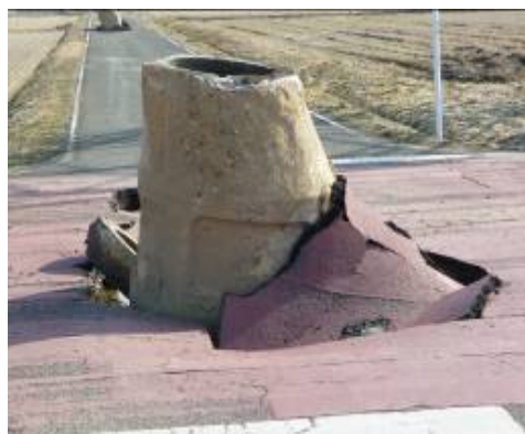
写真3 マンホールの浮上(中通り)
