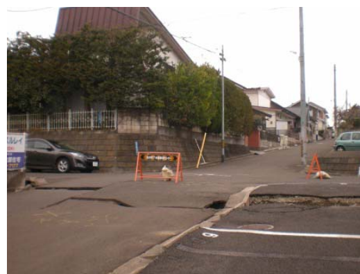
住宅地の道路被災状況
