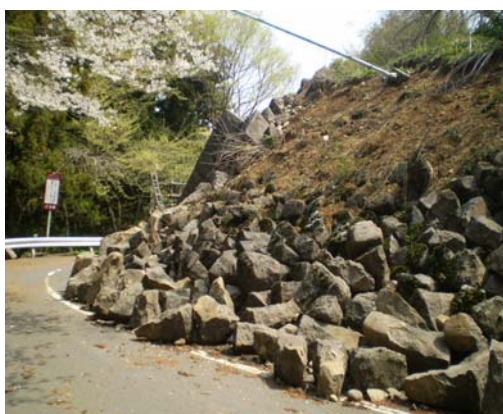
青葉城石垣の崩落
