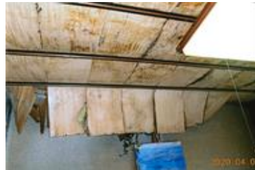
屋根破損による室内状況
