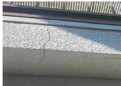
バルコニー軒先のひび割れ
