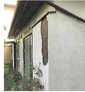
外壁仕上げ材の剥落
