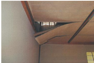
外壁破損による室内状況
