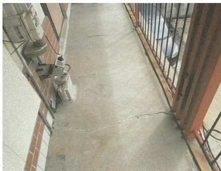
外廊下の床のひび割れ
