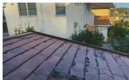
屋根材の腐朽 (石綿セメント板)
