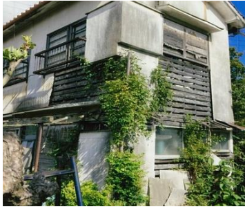
外壁の剥落・下地露出
