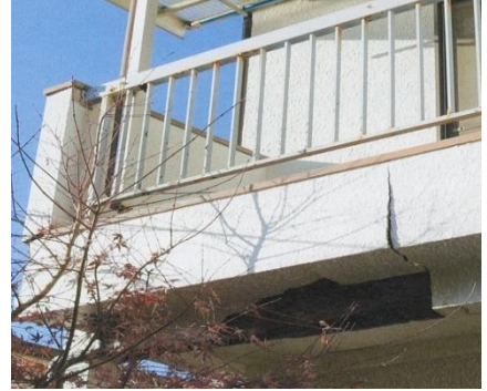
バルコニー部の破損・剥落
