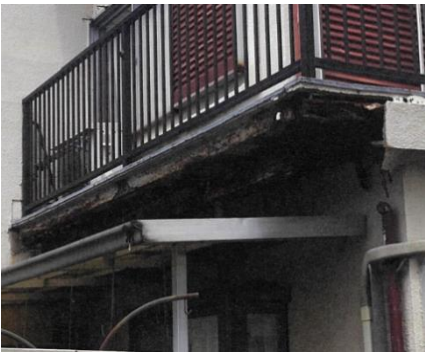
バルコニーの剥落
