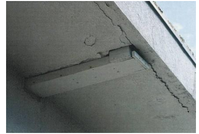
軒天井のひび割れ（軽量鉄骨造）
