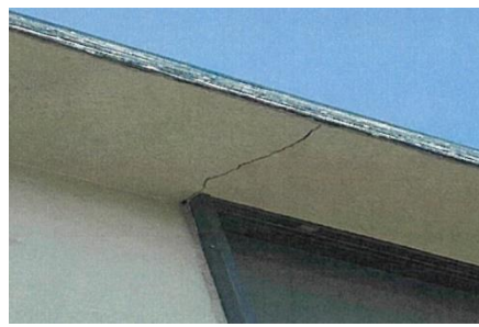
軒天井のひび割れ
