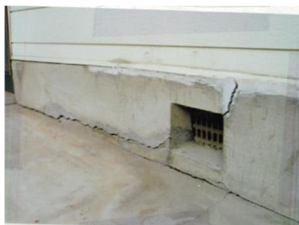
基礎のひび割れ
