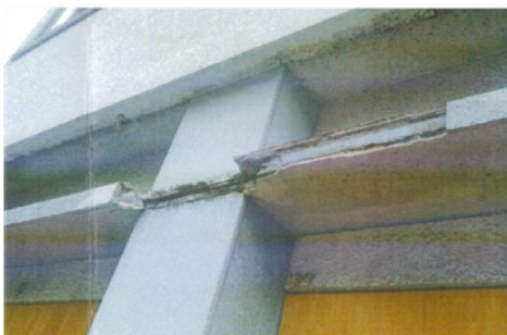
外壁の剥落（RC造）
