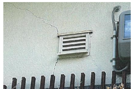
外壁のひび割れ
