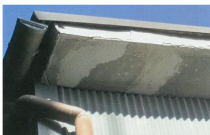
軒天井仕上げの剥落
