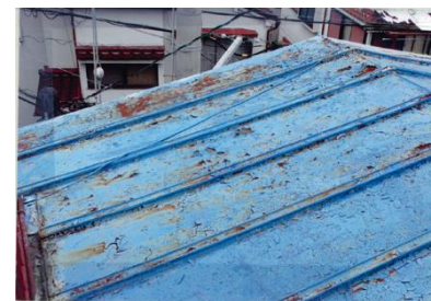
屋根材の腐朽 (金属葺材)
