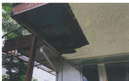
軒天井材の剥落
