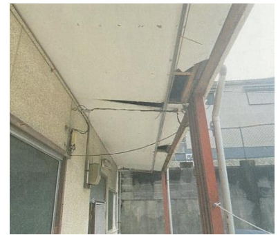
外廊下天井の剥落
