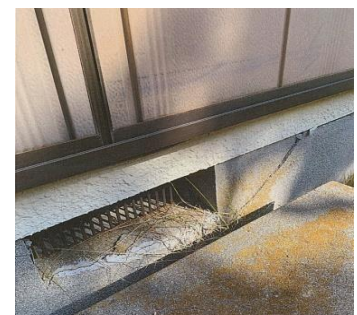
基礎のひび割れ
