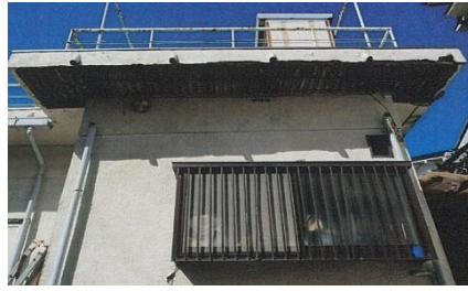
軒天井材の腐食落下（軽量鉄骨造）
