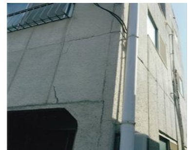
外壁（ALC板）のひび割れ（鉄骨造）
