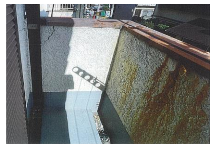
バルコニー腰壁のひび割れ・腐食
