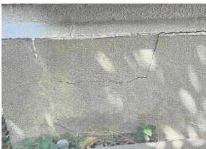
基礎のひび割れ
