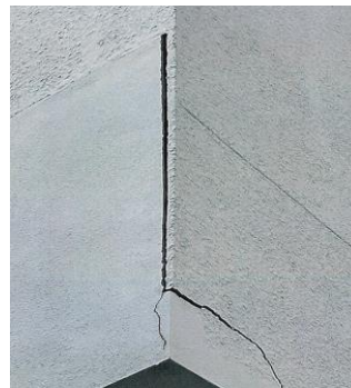
外壁のひび割れ
