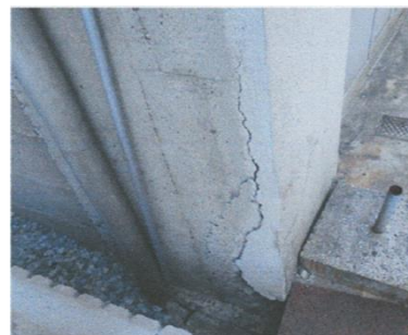
柱のひび割れ（RC造）
