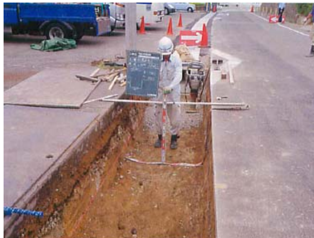
工事区域がセーフティコーン等で区分されていない
