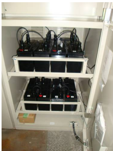
蓄電池の設置状況
