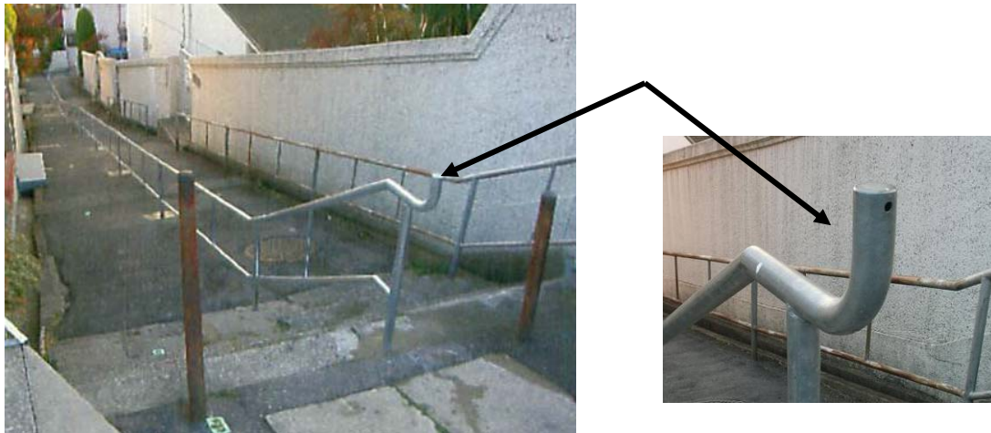
階段の手すり端部が上方方向に曲げられているもの
