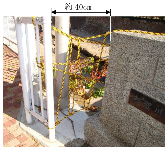
転落防止柵端部と橋梁親柱の間の隙間
