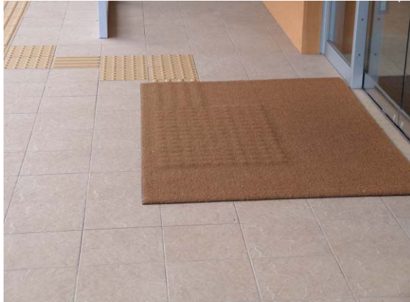
① 出入口マットで隠れた点字ブロック
