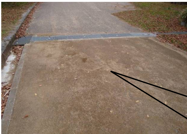
劣化していた路面安定処理工
