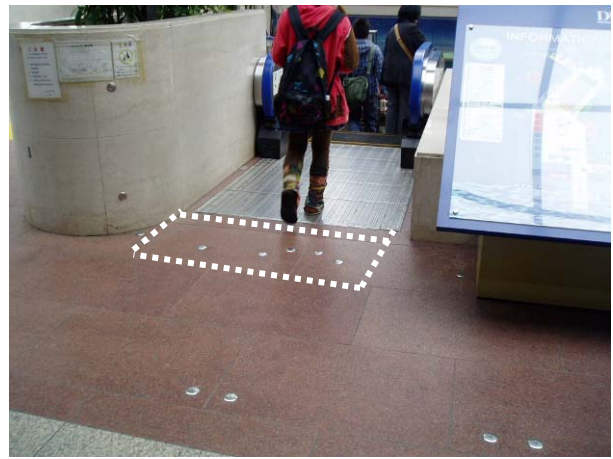
エスカレーター前に点字ブロックが設置されていない
