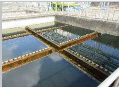
■最終沈殿池 Final settling tanks 反応タンクからの水をゆっくり流し、活性汚泥を底に沈めます。きれいになった上澄水を塩素混和池へ流します。沈んだ活性汚泥は返送汚泥として反応タンクへ戻します。余分な活性汚泥は余剰汚泥として汚泥処理施設に送ります。
