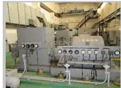
■送風機 Blowers 反応タンクに空気を送り込むことで微生物が活発に働きます。
