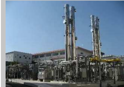
■消化ガス精製設備 Gas upgrading system 高圧水中に消化ガスを通すことでガス中のメタン以外の不純物を取り除きます。
