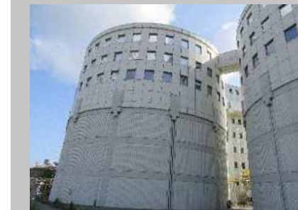
■汚泥消化タンク Sludge digestion tanks 汚泥中の有機物を嫌気性微生物の働きで消化ガスと水に分解し、汚泥の量を少なくするとともに汚泥を安定化させます。
