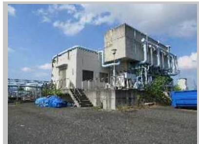
■砂ろ過設備 Sand filtration 水を砂の層でろ過し、きれいにします。きれいになった水は処理場内の機械用水などに再利用します。
