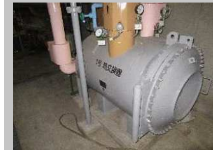
■熱交換機 Heat exchanger ガス発電設備の熱(温水)を利用して汚泥消化に必要な温度(約42度)まで汚泥を加温します。
