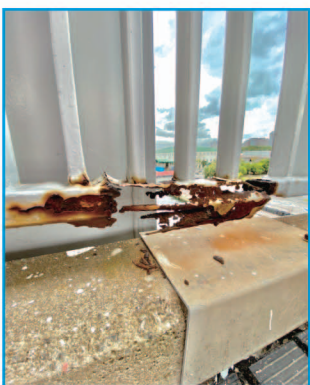
⑳ 六甲アイランド大橋 (補修前)
