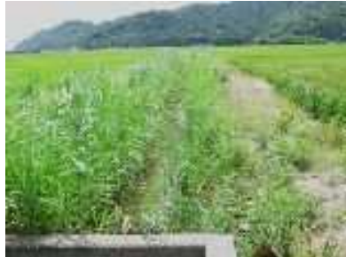
St④. 美浜若狭町境界排水路:圃場整備された水田地帯の集水排水路. 幅60cmのアーム柵排水路. 底床は泥が堆積し水深が20~30cmで土砂で埋没. ヨシも繁茂する.
