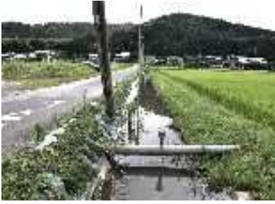
St①-1. 気山芋集落排水路:幅1.5mのアーム柵排水路, 上流域は幅60cmのアーム柵排水路. 川底は泥が堆積. 満潮時に冠水の危険がある.
