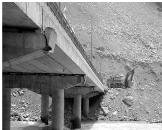
写真-22 落橋防止装置の被災を受けた高速道路の橋梁：汶川県映秀鎮
