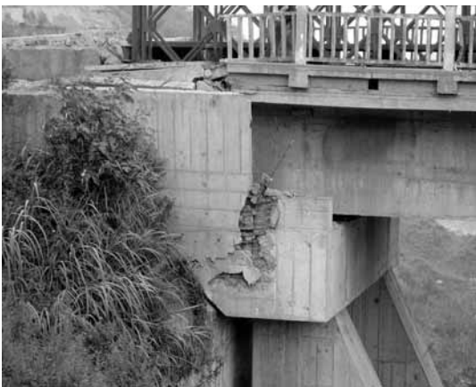
写真-24 被災を受けた寿江大橋の左岸橋台： 汶川県映秀鎮～都江堰市
