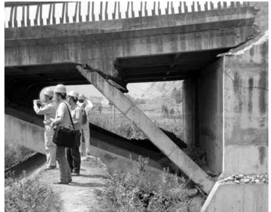
写真-25 被災を受けたコンクリートアーチ橋： 彭州市小魚洞鎮
