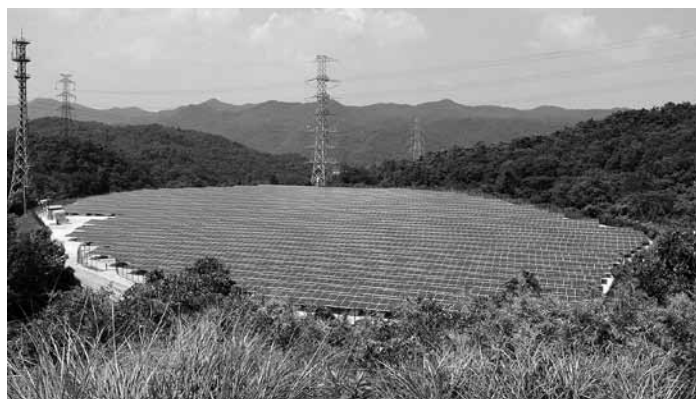
神戸六甲西太陽光発電所
