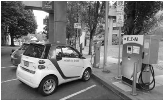
写真3-3 ポートランド州立大学内の電気自動車充電設備
