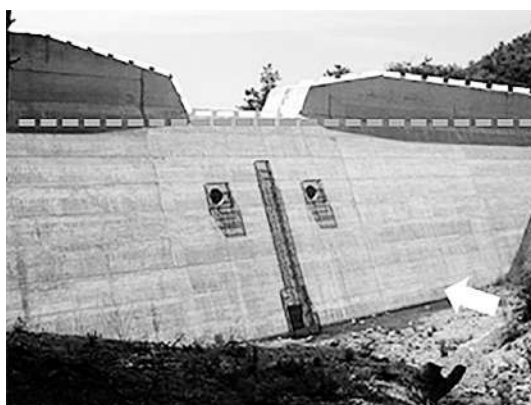
災害前（東船坂えん堤）
