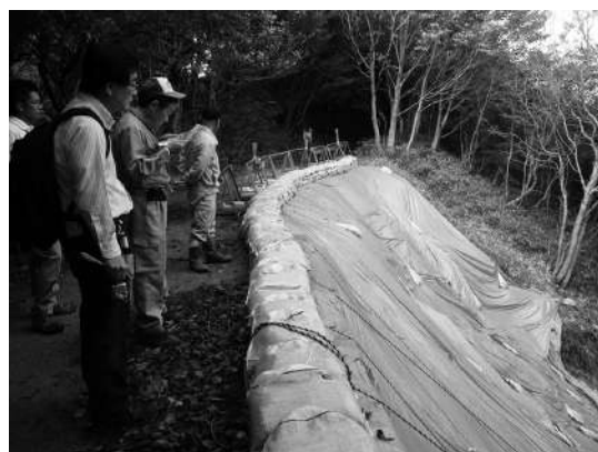
写真-3 2014年北六甲豪雨により出現した登山道からの崩壊
