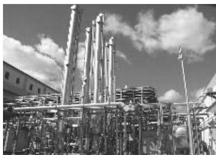
写真1：こうべバイオガス精製設備
