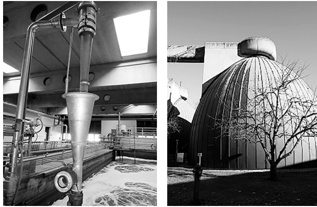
写真5：(左) アナモックス反応槽と汚泥分離用サイクロン (右) 消化タンク
