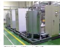
信州ビバレッジのヒートポンプ
